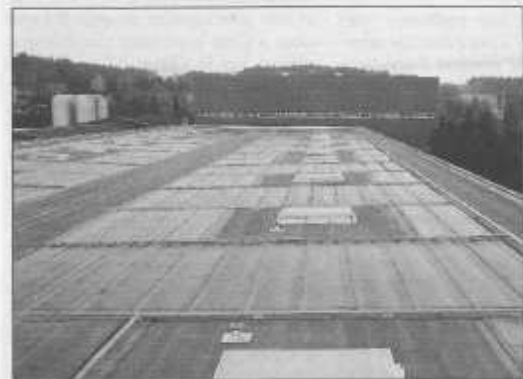
Installés par EDF, 1800 m 2 de panneaux souples photovoltaïques équipent la toiture de ce nouveau bâtiment de stockage qui produit en électricité l'équivalent de la consommation annuelle de 50 foyers.
